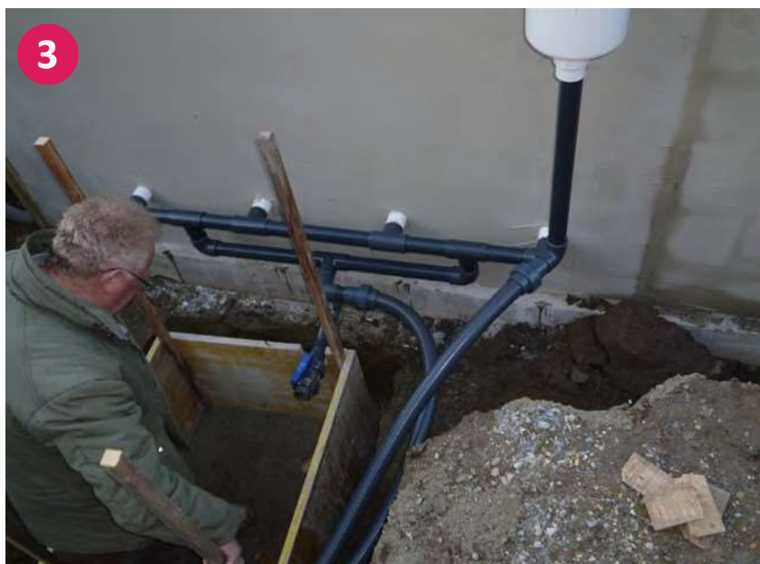
Potrubí trysek, skimmeru a podlahové vpusti
