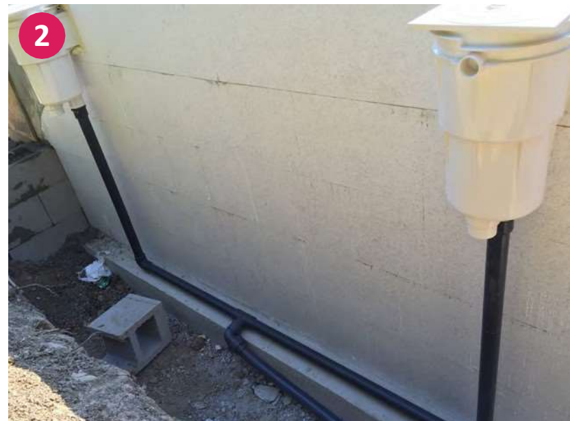
Potrubí pro 2 skimmery
